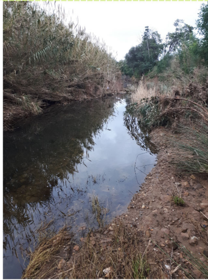
Figure 38 : Colmatage par les algues
